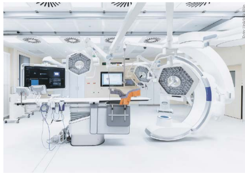
Dieser Hybrid-OP-Saal mit deckenmontierter Röntgen-Anlage vereint modernste bildgebende Verfahren mit der Funktionalität eines voll ausgestatteten Operationssaals.
