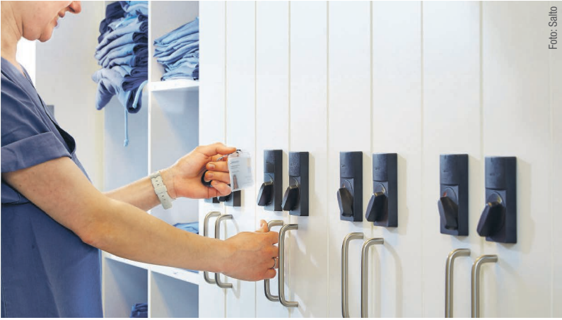
Elektronische Zutrittskontrolle bindet neben Türen und Toren auch Aufzüge und Spinde in die zentrale Verwaltung ein. Sie bringt auf diese Weise ein effizientes digitales Management mit höchsten Sicherheitsanforderungen in Einklang.
