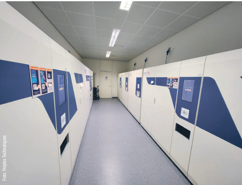
Hygienisch, organisiert, schleusenfrei: In diesem Raum werden ca. 700 Mitarbeiter mit frischer Dienstkleidung versorgt.
