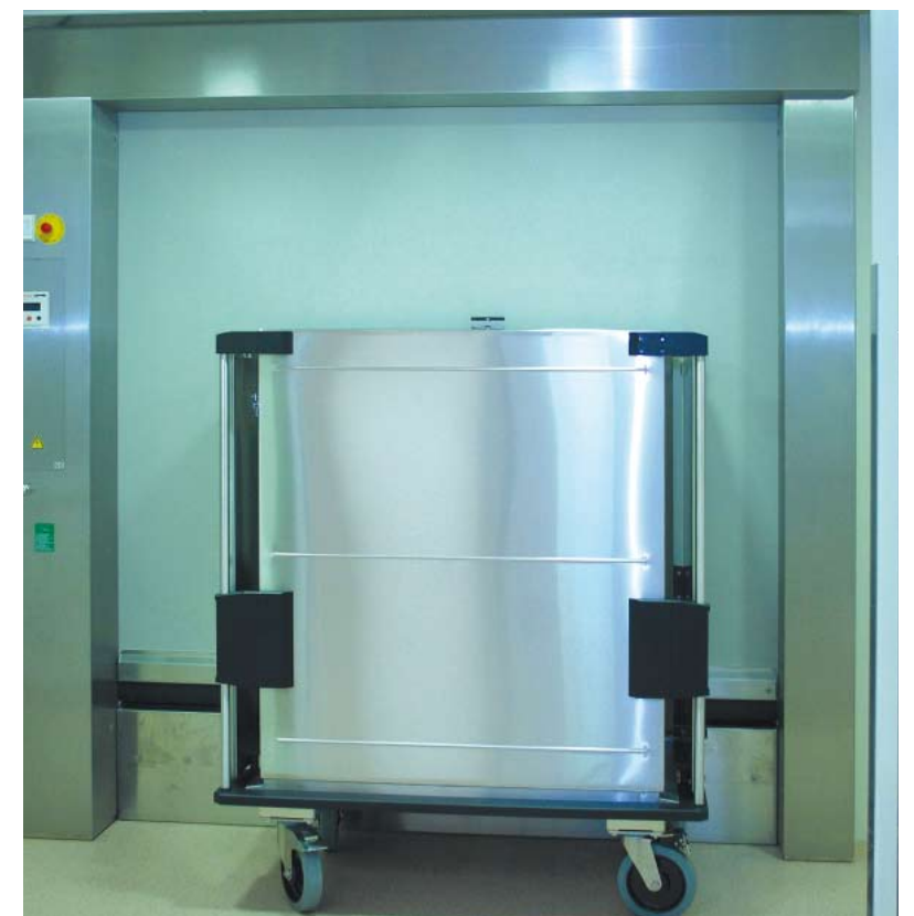
Im Krankenhaus Vilshofen an der Donau ist das hoch dichtende Reinraumtor von Efaflex vorgesehen, um den Sterilbereich von den Logistikflächen abzutrennen. Es bildet den Abschluss des Sterilbereiches mit der Autoklaventnahmeseite hin zur Containerbeladung auf ebenfalls sterilem Transportterrain.
