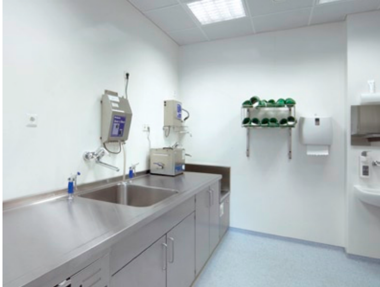
Fugenlos und flüssigkeitsdicht – Altro Whiterock eignet sich für alle hygienesensiblen Bereiche in Klinik und Praxis.
