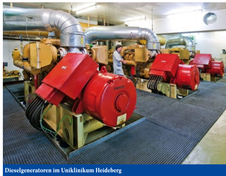
Dieselgeneratoren im Uniklinikum Heidelberg
