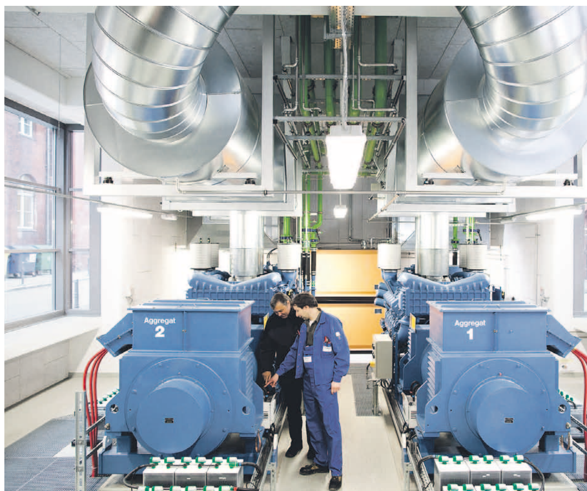
Die beiden Aggregate mit MTU-Dieselmotoren haben eine elektrische Leistung von insgesamt rund 1.700 kVA und übernehmen innerhalb von zehn Sekunden den Notstrombetrieb. Bild: MTU
