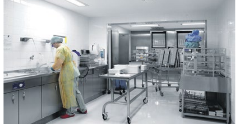
Für den Sterilisationsbereich der Klinik wurde - ebenso wie für den Massage- und Bäderbereich - mit der Leuchterserie pro-tection eine moderne, wartungsarme Lichtflächenlösung von Regiolux gewählt. Sie sorgt als Einbauleuchte mit höherer Schutzart (IP 54, d.h. geschützt vor Staub und Spritzwasser) in Multiwatt-Version für beste Hygiene-Verhältnisse. (Foto: Inga Paas für Regiolux)
