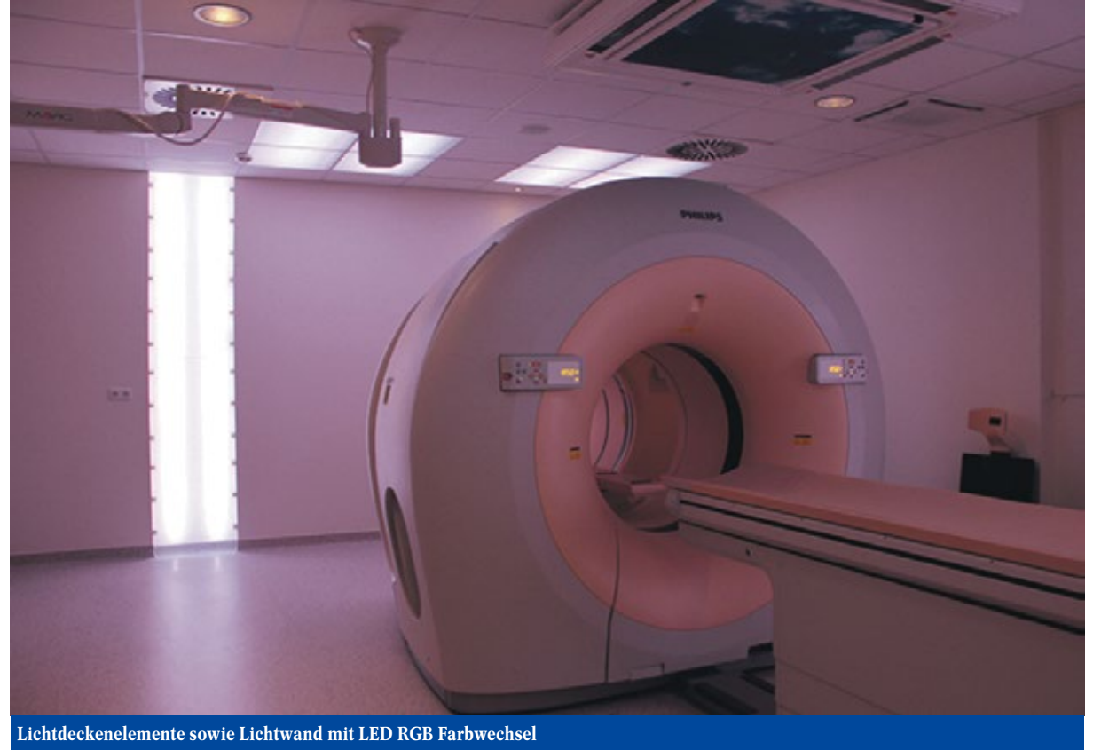
Lichtdeckenelemente sowie Lichtwand mit LED RGB Farbwechsel
