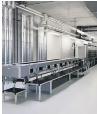
Apotheke Mannheim, Kommissionieranlage. Foto: Carpus+Partner, Jörg Stanzick.
