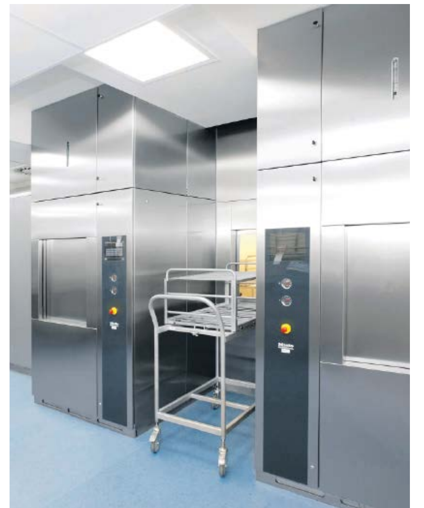
Zwei Groß-Sterilisatoren von Miele mit vertikaler Türöffnung im Krankenhaus des Marienstifts Braunschweig: Hier werden je sechs Sterilguteinheiten pro Charge aufbereitet. Die neue ZSVA im Marienstift ist seit Ende April 2012 in Betrieb und wurde komplett von Miele ausgestattet. Foto: Miele
