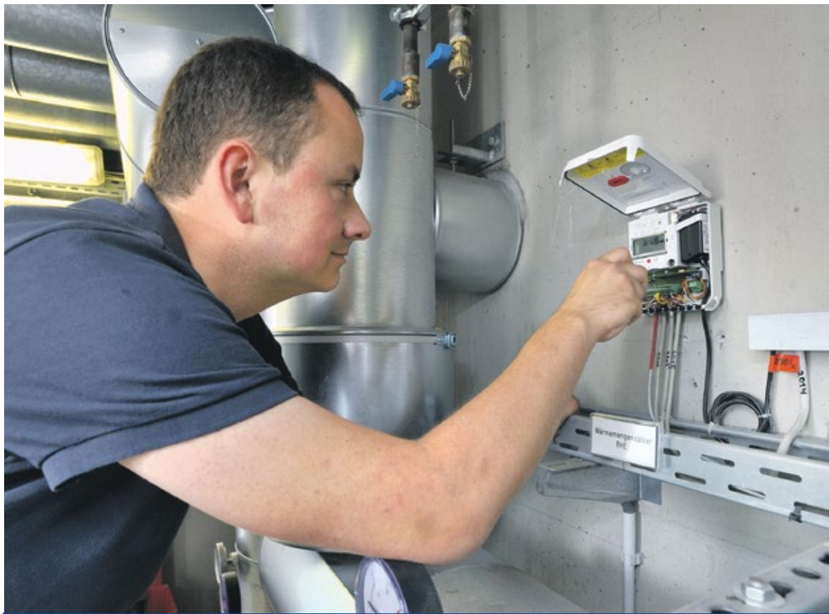
Anschluss eines Impulskontakts zur Wärmemengenmessung
