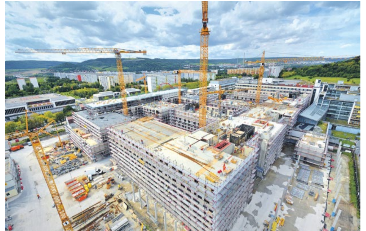
Blick auf die Baustelle für den zweiten Bauabschnitt des Universitätsklinikums Jena. 2016 werden die ersten Gebäude in Betrieb genommen. Foto: UKJ/Szabo
