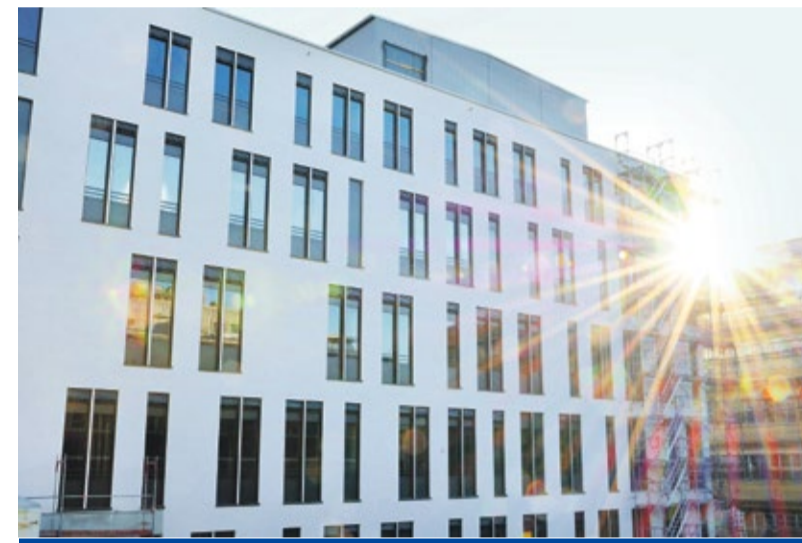
An manchen Stellen ist das Baugerüst bereits abgebaut und gibt den Blick frei auf die Fassade des Neubaus. Foto: UKJ/Szabo
