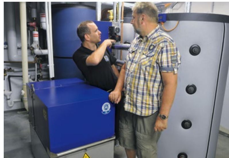
Andreas Richter (Bauherr) und Thomas Meyer (Planer) vor dem XRGI 9 und dem 1.400-l-Speicher. Die BHKW-Installation hat etwa 40.000 € gekostet. Wartungsturnus alle 10.000 Stunden. Foto: EC Power
