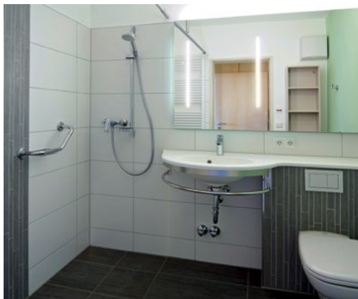
König Bäder ersetzte alle Badewannen durch bodengleiche, barrierefreie Duschen. Dadurch wirken die Bäder trotz ihrer kleinen Grundflächen von nur dreieinhalb Quadratmetern großzügiger.
