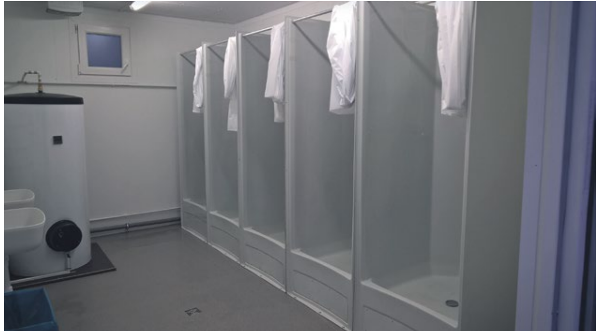
Blick in einen Duschcontainer in einer Erstaufnahmeeinrichtung in Deutschland.
