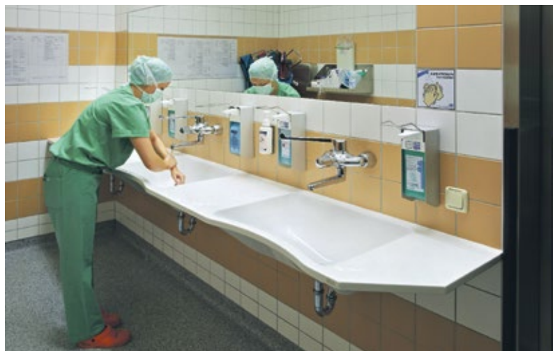
Die ergonomisch geformten, großzügigen Mulden mit reduzierter Ausladung im Armaturenbereich ermöglichen Ärzten und dem Klinikpersonal komfortables Waschen und Desinfizieren der Hände und Arme am neuen Reihenwaschtisch. Foto: Franke Aquaretter GmbH
