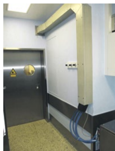
Abb. 2: Schlauchführung vom Entsorgungsraum in den OP-Saal über Kanalschacht Foto: Dr. W. Ebner, Dr. T. Götting/Universitätsklinikum Freiburg
