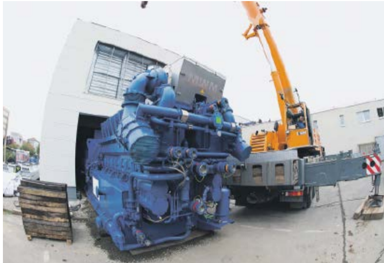
Das „Herzstück“ des neuen BHKW: der Motor für den Generator wird in das Gebäude eingebracht. Foto: umg/sporförner
