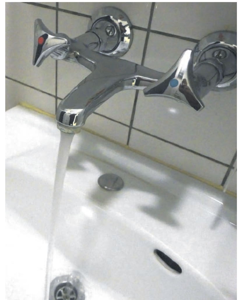
Mögliche Quellen für direkte Wasser-assoziierte Infektionen sind warmes oder kaltes Trinkwasser aus den Wasserhähnen. In Aufenthaltsbereichen immungeschwächter Patienten sind daher endständige Wasserfilter als Maßnahme seitens der technischen Hygiene zu empfehlen.
