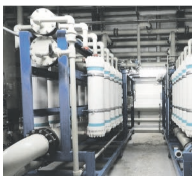
Eine Ultrafiltrationsanlage entfernt durch extrem feine Membranstränge antibiotikaresistente Bakterien aus dem Abwasser.
