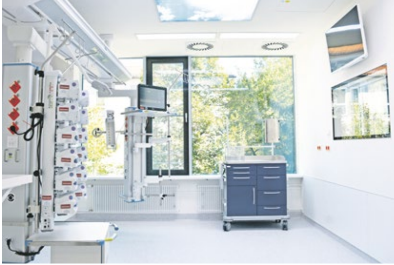
Das Himmelspaneel und die Raumbelichtung in den Patientenzimmern werden von einem Tageslichtsensor an der Außenfassade gesteuert, der einen annähernd natürlichen Tag-Nacht-Rhythmus erzeugt, was wiederum die Genesung der Patienten unterstützt.
