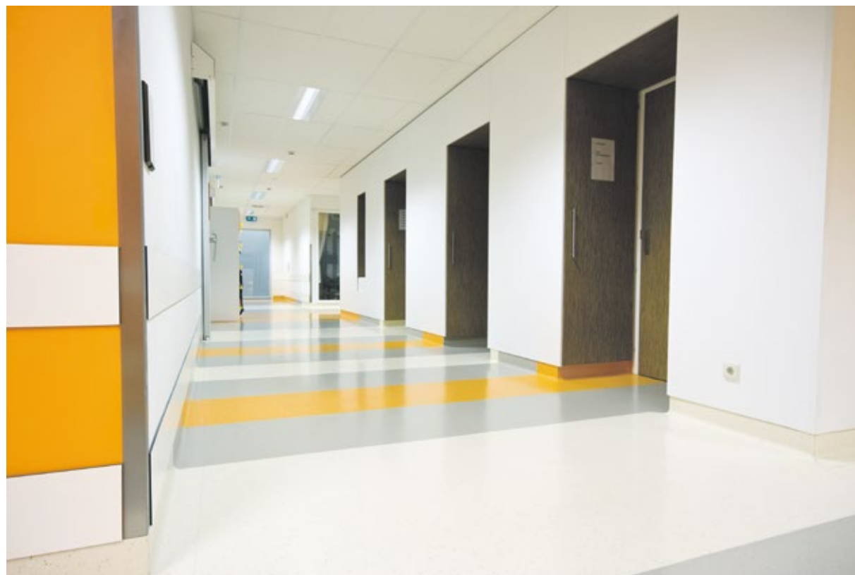
Krankenhausflur Klinikum UMC Utrecht: Frischer Wind durch mit coloriertem Lack sanierter Boden
