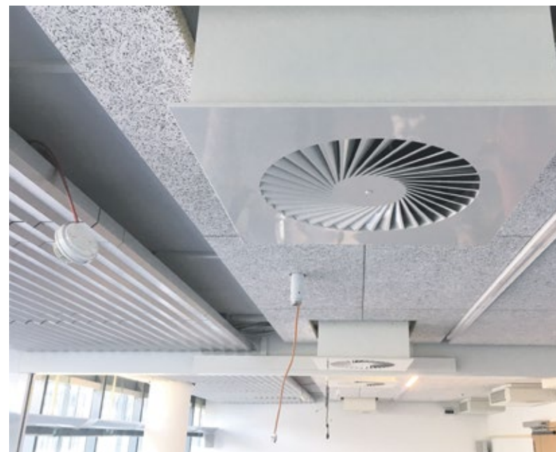
Während der Bauphase am Neuen Kranzler Eck: Das Umluftdeckengerät LH-UL 250 ist als Standardgerät mit einem Ionenerzeuger vom Typ LH-MAG 1000 sowie einem Ozonerzeuger vom Typ LH-O3 bestückt. Foto: GSB
