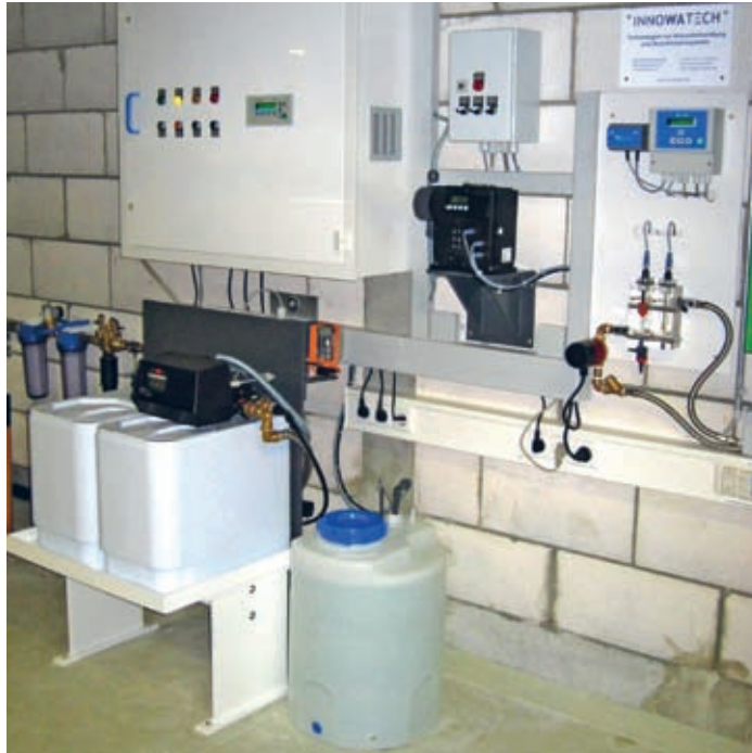
Innowatech Aquadron FXL, Messwert-gesteuerte Warmwasserbehandlung in einem Universitätsklinikum
