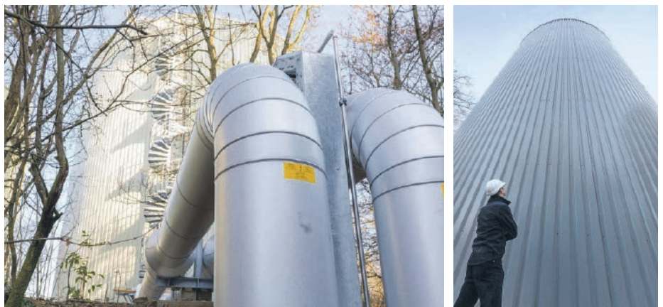
Der neue Kältespeicher auf dem Campusgelände des Universitätsklinikums Heidelberg
