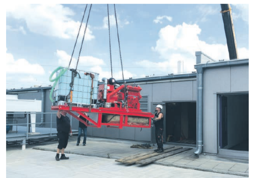
Das Blockheizkraftwerk aus Springe ist jetzt in der KRH-Zentralküche im Einsatz.
