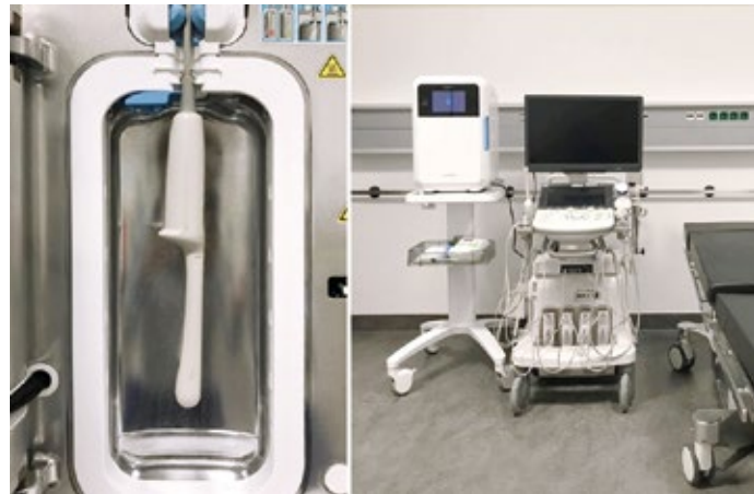
Abb. 3: Eingriffsraum des interdisziplinären US-Zentrum: Ein semisteriler Raum gewährleistet hohe Flexibilität in der US-Intervention. Der direkt im Setting integrierte Desinfektionsautomat erlaubt hierbei eine nahe, einfach durchzuführende und standardisierte Sondaufbereitung, welche in die Prozessdokumentation von US-Interventionen integriert wird. Die Aufbereitung der transrektalen Ultraschallsonde (links) erlaubt den Ärzten/Ärztinnen eine Prozedur der Sondaufbereitung, welche zwischen den Patienten im klinischen Setting ohne großen Zeitverlust und standardisiert durchzuführen ist.
