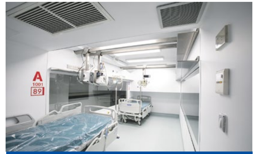
So sicher wie eine reguläre Isolierstation, dank der Bioabdichtung mit Unterdruck
