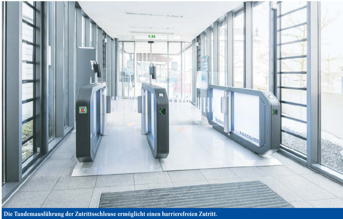
Die Tandemausführung der Zutrittschleuse ermöglicht einen barrierefreien Zutritt.
