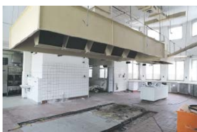
Hier wird zuerst gebaut: Das Haus D, die einstige Küche, wird sowohl von außen als auch von innen ein völlig neues Gesicht erhalten.
