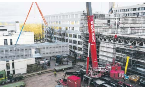
Das Stellen der 20 x 4 m großen und 28 t schweren Module war Millimeterarbeit.
