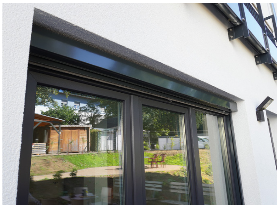
Vorrichtung zur Verschattung an den Fenstern
