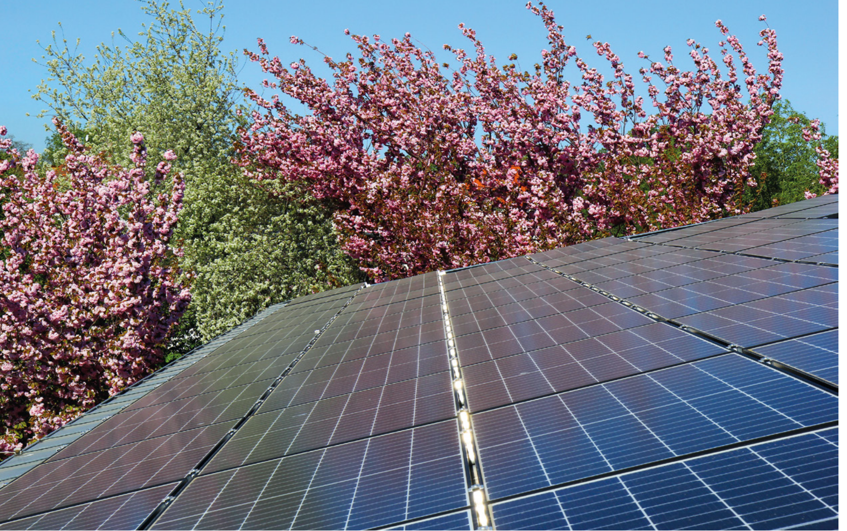
Der Bereich Energie bietet auch in der stationären Pflege eine wirksame Stellschraube im Klimaschutz.
