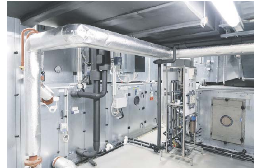
Das adiabate Hybrid-Luftbefeuchtersystem bietet einen Betriebskostenvorteil und erfüllt gleichzeitig hohe Hygieneanforderungen.
