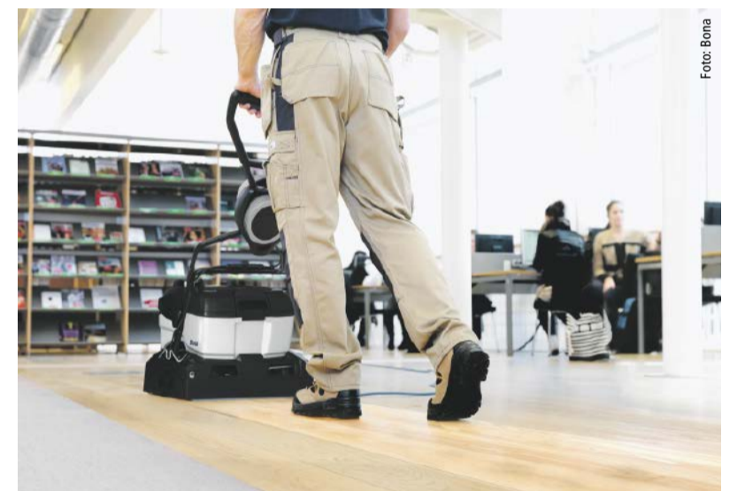
Auch Designböden lassen sich problemlos erneuern. Das ermöglicht eine Sanierung auch über verschiedene Flächen und Untergründe hinweg.
